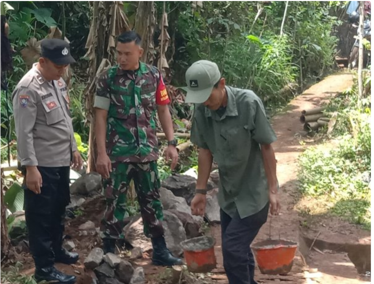
Bhabinkamtibmas Desa Nyalindung Polsek Nyalindung Polres Sukabumi Bersama Babinsa dan Kades Pantau Pembangunan Jembatan Penghubung
